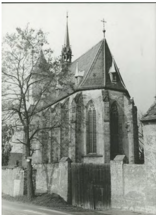
Pohled od jihovýchodu. Foto:1976–1977. Zdroj: Vlastimil ŠAFRÁNEK, Kostel sv. Jakuba Většího ve Slavětíně, stavebně historický průzkum, fotodokumentace , foto č. 4.
